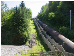
une conduite forcée
